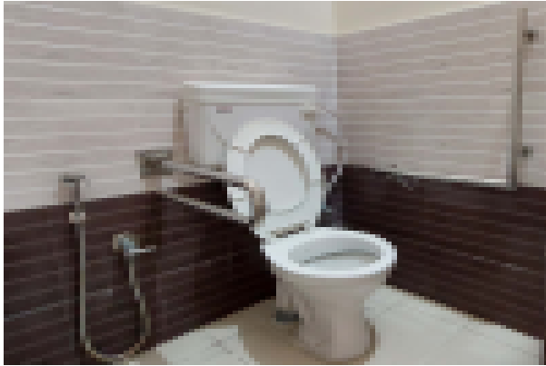
CWSN TOILET PHOTO
